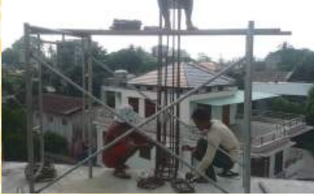
安全対策がされていない建設現場
